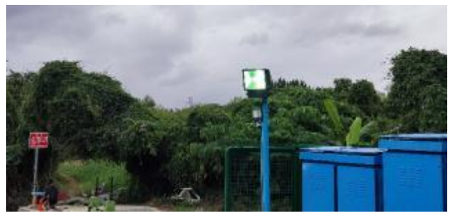
圖四.抽水機設施監控設施完整
