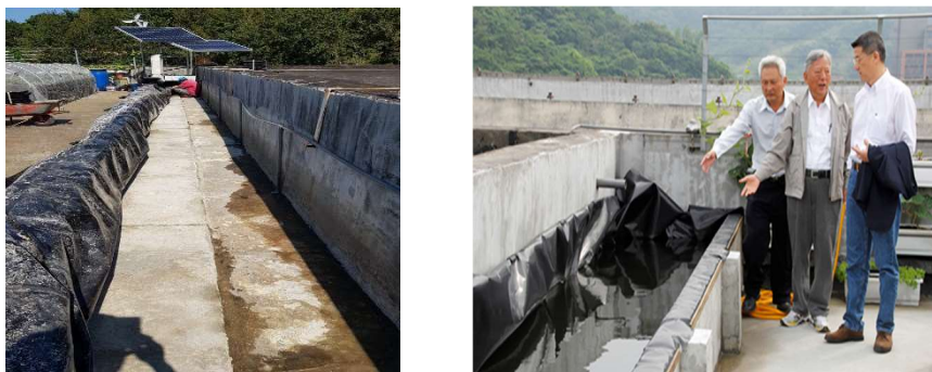
圖 1 大安銀髮開心農園雨水回收貯留槽
