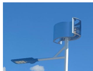
圖四 現有風力發電實地拍攝
